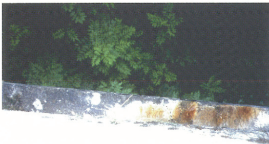
(写真-7) 上橋、版アーチ変色部 (俯瞰)
