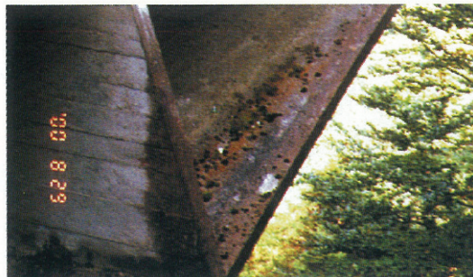
(写真-9) 上橋、雨露に曝された部分
